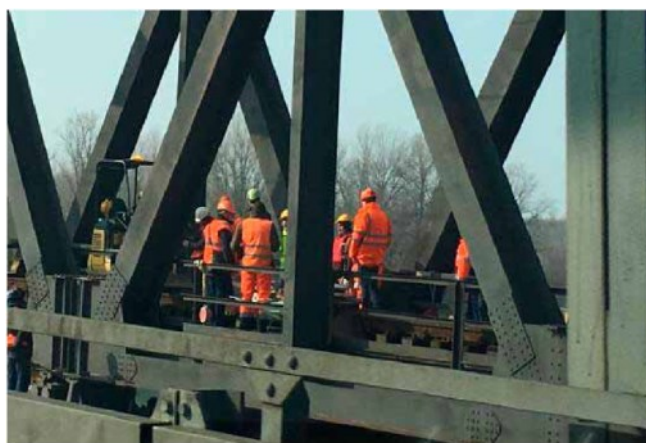
Personale delle Ferrovie dello Stato al lavoro sul ponte della tratta per Piacenza
